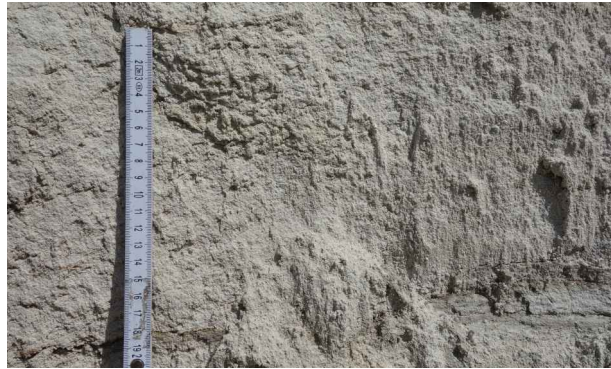
Abb. 4: Nahaufnahme der Abbauwand in der Sandgrube Rosenfeld-Brittheim (RG 7718-2); die Sandsteine sind schwach gebunden und wittern rasch auf.
